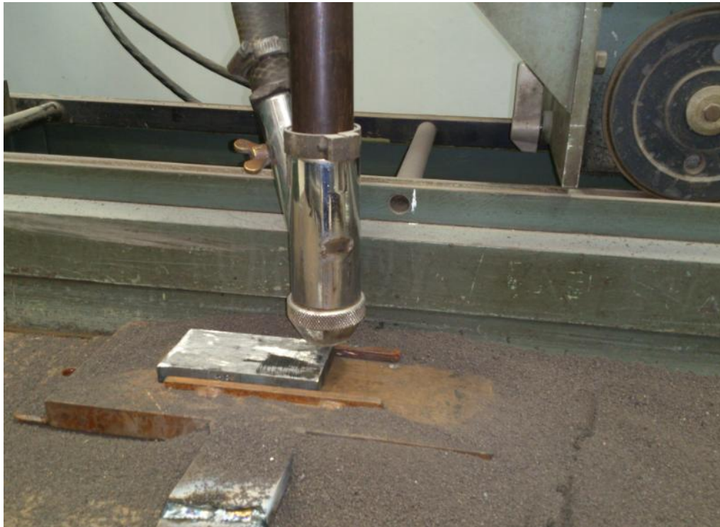
Figura 26 - Posição do gabarito em relação ao equipamento de soldagem a arco submerso
