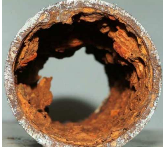
Figura 1 – Tubo petrolífero em processo de corrosão.
