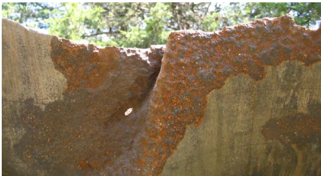
Figura 20 - Foto mais detalhada da corrosão externa identificada no duto
