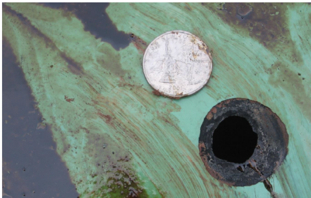
Figura 21 - Foto do furo que deu início ao vazamento do duto
