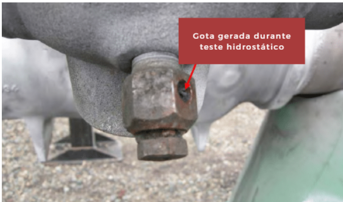
Figura 22 - Local do vazamento no duto de Diesel
