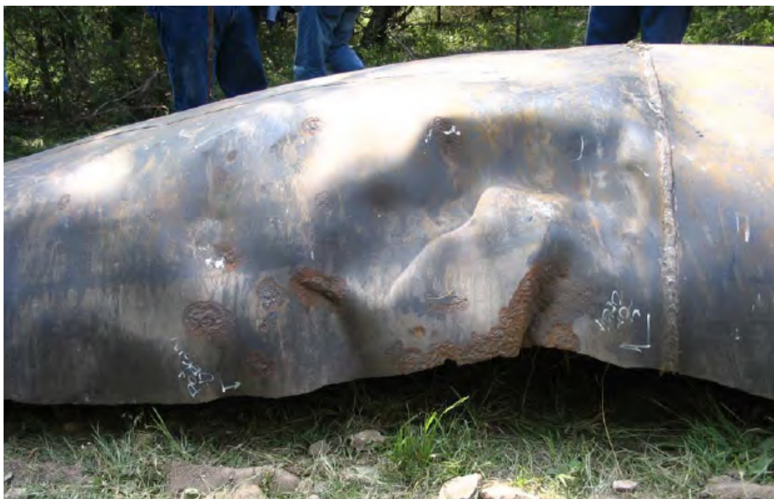
Figura 19 - Foto da corrosão externa identificada no duto
