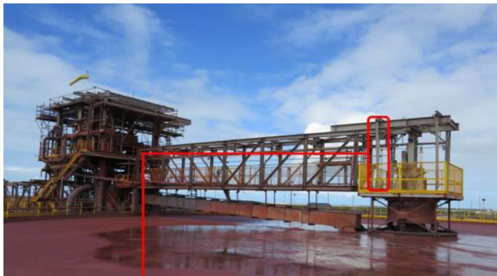
Figura 3.8 – Local onde a corrosão foi observada no espessador de minério de ferro
