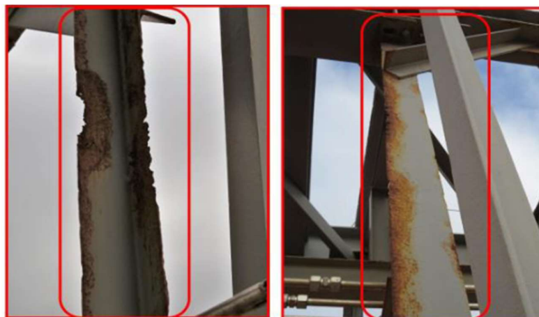
Figura 4.2 – Vigas do espessador de polpas contendo pontos de corrosão
